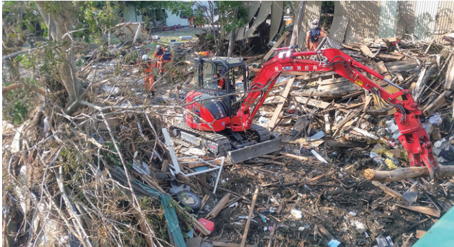
重機による瓦れき・流木の排除（岩泉町安家地区） （仙台市消防局提供）
